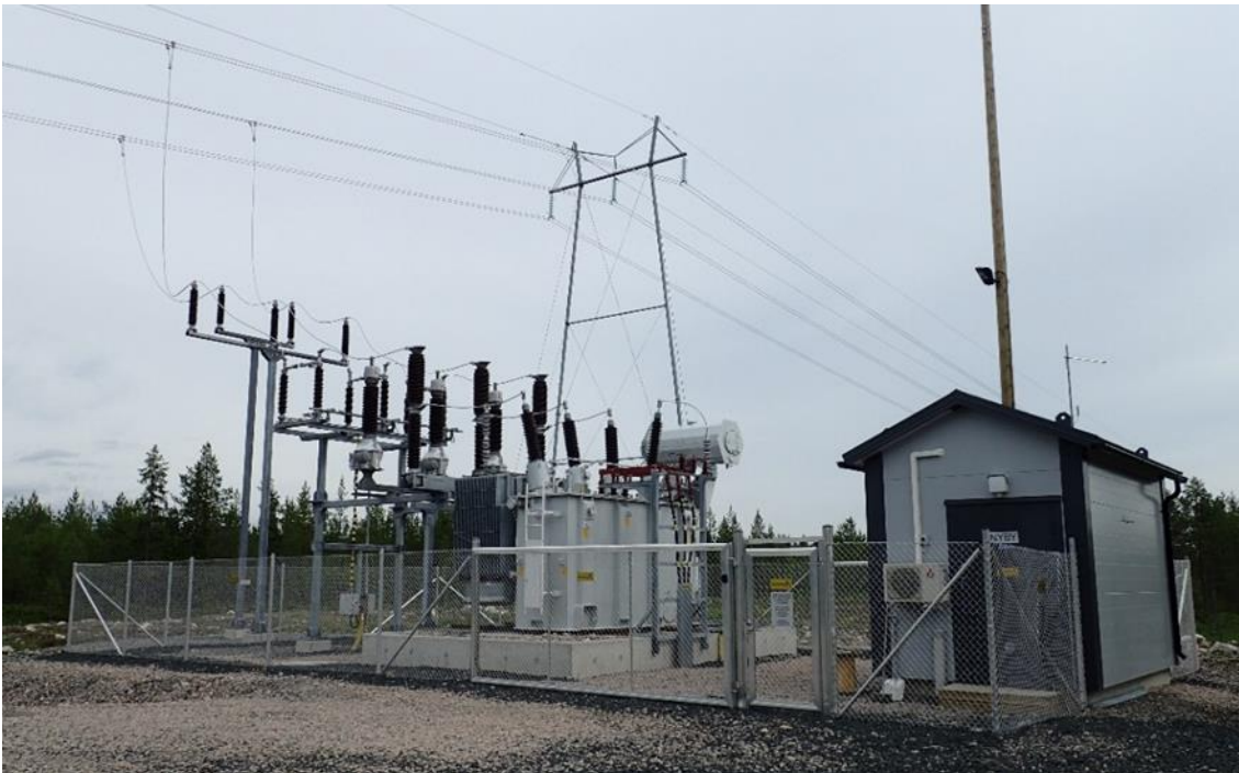
Kuva 4-10. Esimerkki tuulivoimapuiston sähköasemasta.
